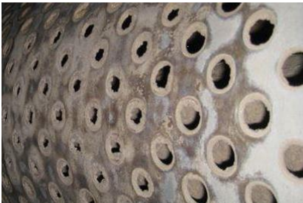
Po 150 dniach od instalacji widać, że otwory są drożne
