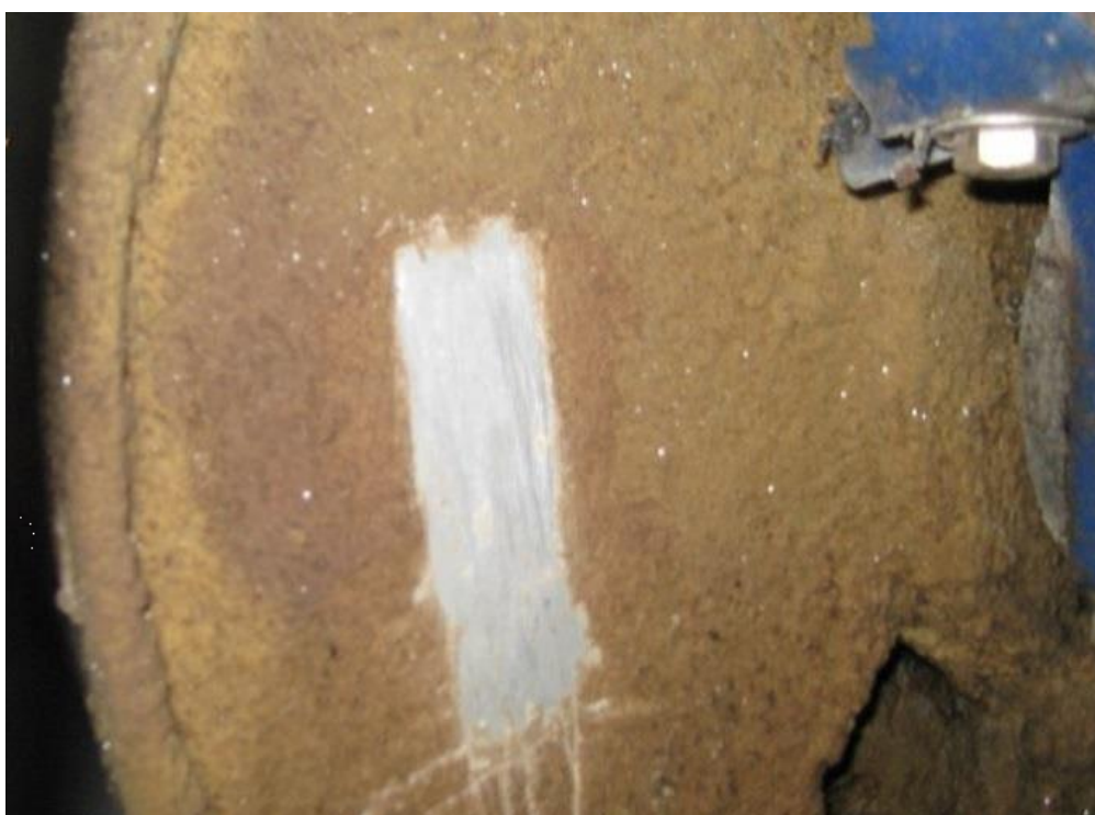
Na zdjęciu osady na pokrywie przed instalacją HydroFLOW CUSTOM
