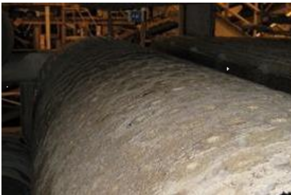
Widoczne osady struwitu blokowały otwory w bębnie
