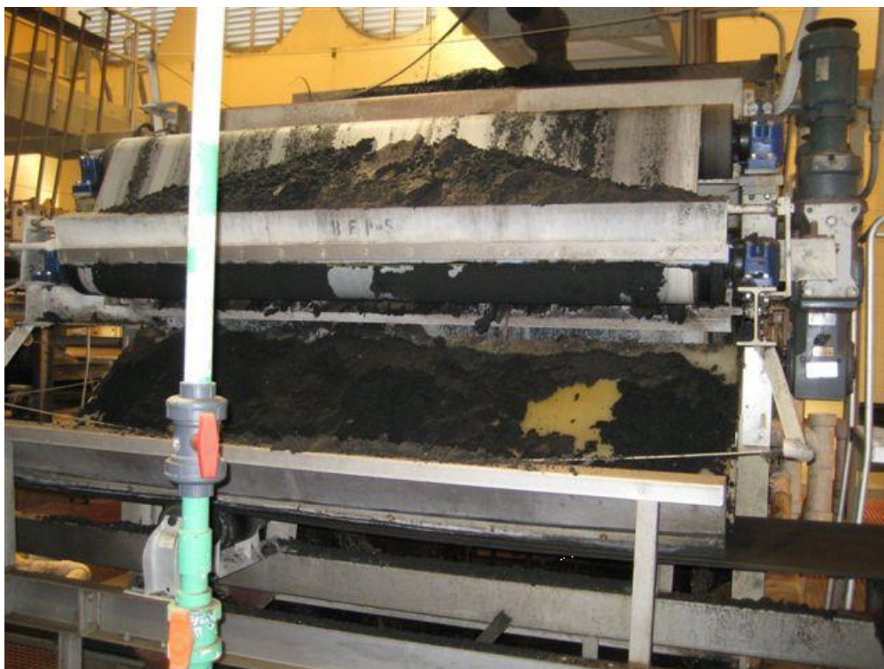
Prasa taśmowa w oczyszczalni ścieków
