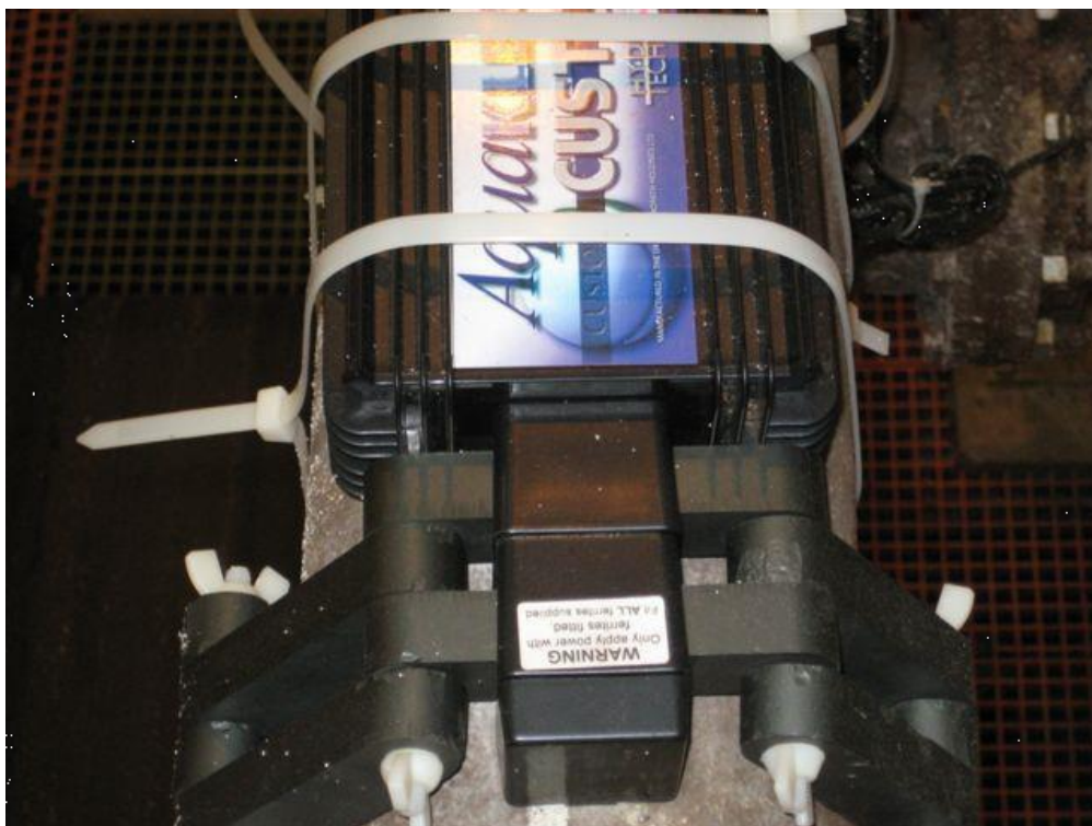
Urządzenie AquaKLEAR HydroFLOW CUSTOM 12" zamontowane w oczyszczalni
